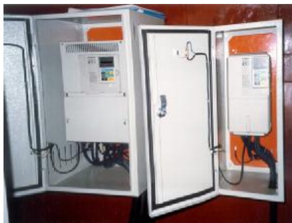
Razvodni orman sa regulatorima pumpe:
